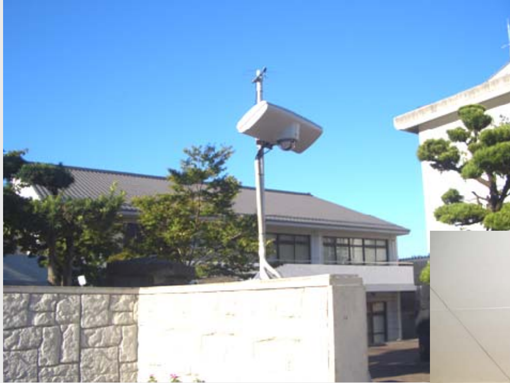
校門へのリーダー設置状況
